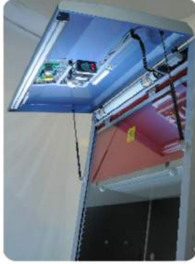
Kontamine bölgeden izole ve kabin dışından kolay müdahale edilebilen elektrik kontrol ünitesi
